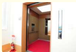
エレベーター
